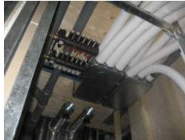
collettori VMC – impianto radiante a soffitto
