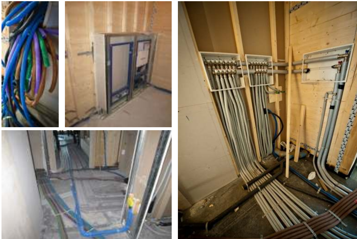
impianti idrico - elettrico – aspirazione - cassette WC
